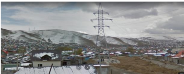
Зураг 3. Орон сууцны хороолол болон гэр хороолол дунд байрлах өндөр хүчдэлийн шугамууд
