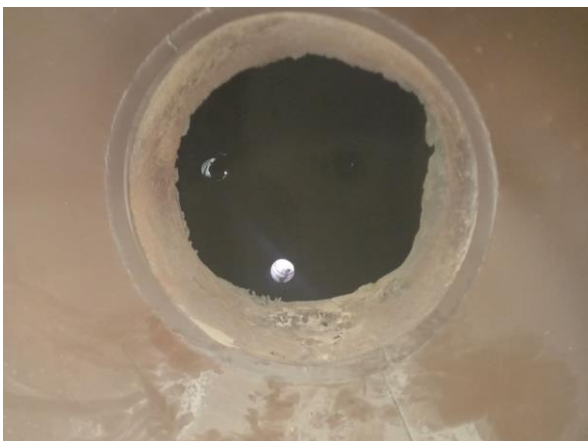
7-р зураг. Амбалзурын галд тэсвэртэй бетоныг буруу хийсэн байдал.
