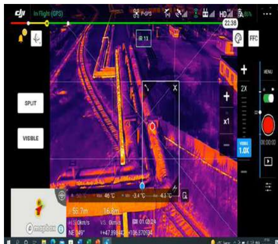
3.3-р зураг. Шугамын дулааны тархалтыг хэмжихэд дулаалга нь элэгдэлд орсон хэсэг дээр температурыг нь хэмжиж буй байдал
