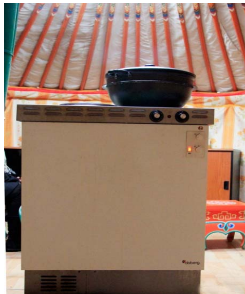
Зураг 2. МонВатт ХХК компани Тулгат-4 кВт-ын цахилгаан зуух суурилуулсан байдал.
